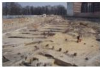
Wykop budowlany przy ulicy Podwale (przy Muzeum Poczty i Telekomunikacji). W dnie wykopu odsłonięte zostały osady rzeczne Odry/Oławy i utwory antropogeniczne powstałe w związku z rozbudową i utrzymaniem obwałowań ziemnych oraz fosy obronnej.
