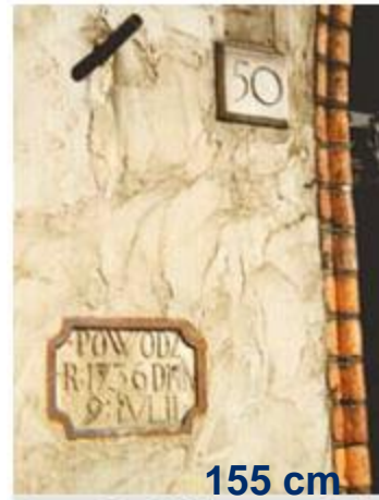
Rys. 2. Tablica powodziowa u wejścia do kamienicy u Starym Rynku 50 w Poznaniu (fot. B. J. Wosiewicz)
